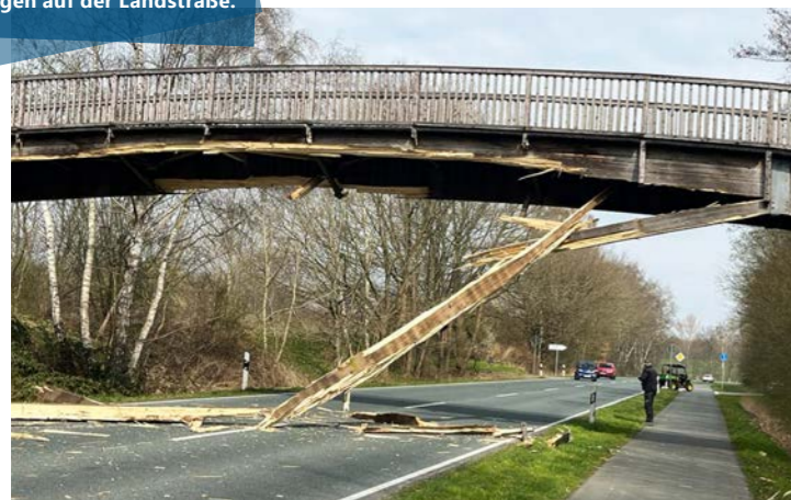
Die abgerissenen Teile der Unterkonstruktion liegen auf der Landstraße.
